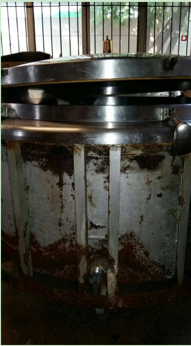
Panelas estão sem condição de uso.
